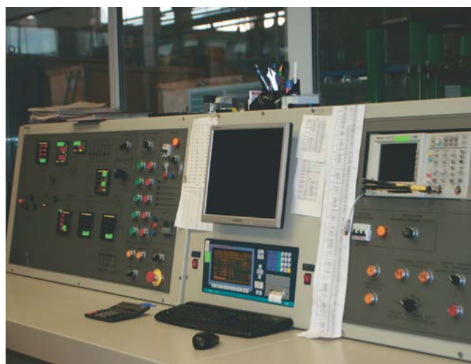
Испытательная лаборатория сухих трансформаторов СВЭЛ
